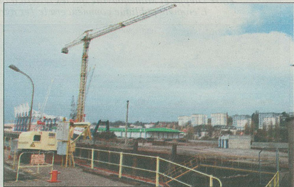
Bassin de commerce, jeudi. Si l'estimation du coût est satisfaisante, c'est ici que le nouveau chantier Allais se construirait, au bout du bassin de Paris. Les murs pourraient alors être élevés très rapidement grâce à une méthode finlandaise.
